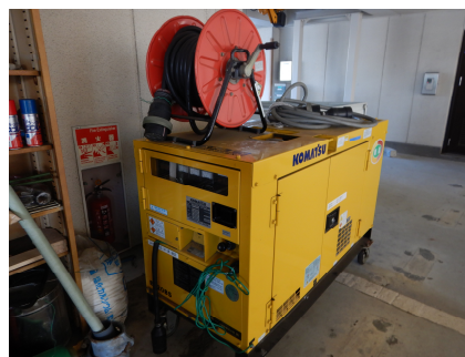
可搬式自家発電機
