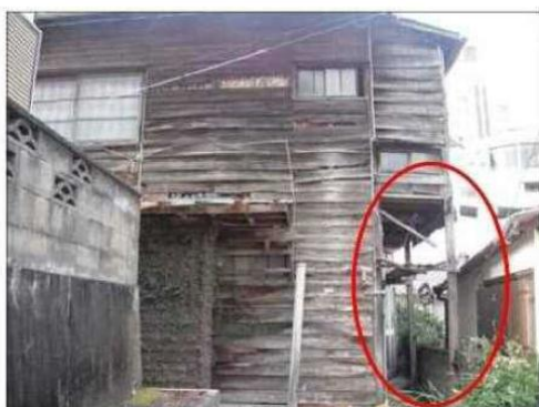
柱の数箇所に破損がある例
