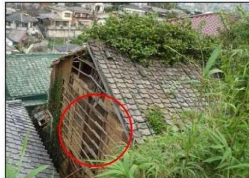
外壁が剥落し、著しく下地が露 出するとともに、壁体を貫通する 穴を生じている例
