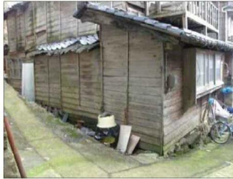
外壁が裸木造の例
