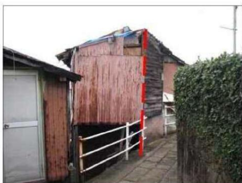
一部の柱が傾斜している例
