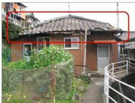
屋根に不陸がある例
