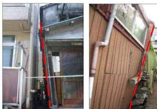
柱の変形が著しく崩壊の危険がある例
