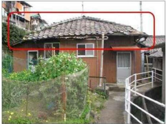
屋根に不陸がある例
