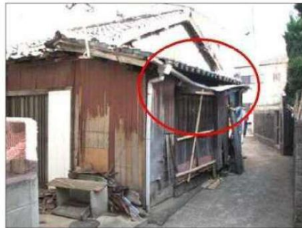
雨樋が壊れており、機能的には雨樋はないと同様の例
