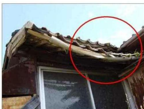
軒の裏板、たる木等が腐朽し、 軒が垂れ下がっている例
