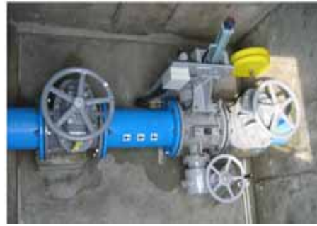
(写真) 緊急遮断弁
