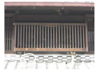
格子で覆った室外機
